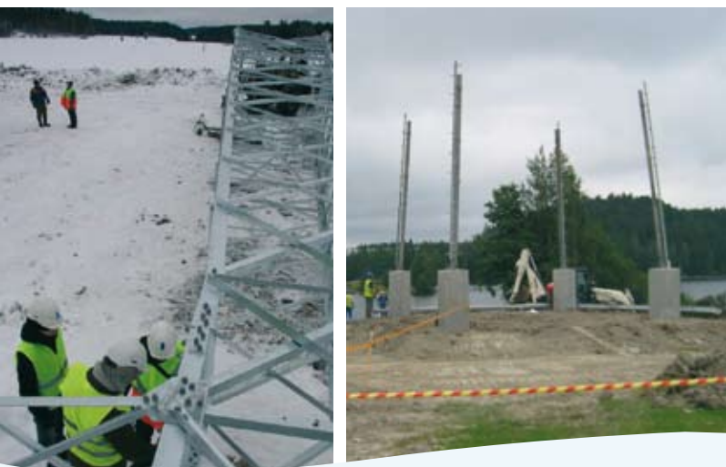
Kahden virtapiiriin 400 kV pylväs vaatii suurehkot perustukset. Perustustyöt ja pylväiden pystytys pyritään ajoittamaan routa-aikaan.
